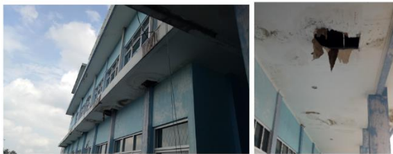
Gambar 1. Sejumlah kerusakan pada gedung F Universitas Muhammadiyah Sukabumi
